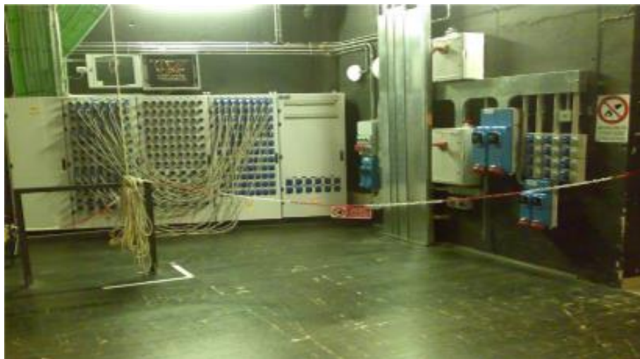
Lato sinistro con quadri di distribuzione e spinamenti dimmer
